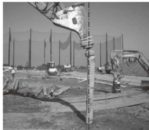
図-5 鉛直性が確保されていない状態
